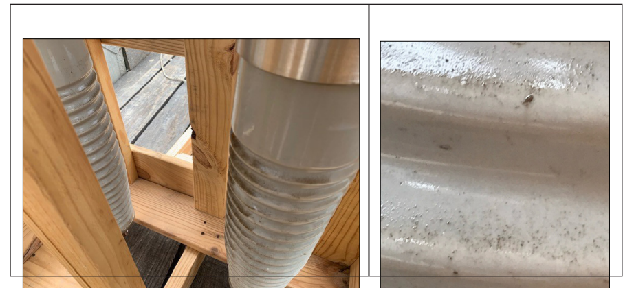
Figura 4: Bushing de alta tensión extraído del transformador: contaminación de la superficie del aislador inferior.
