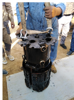
Figura 7: OLTC resistivo retirado para inspección visual
