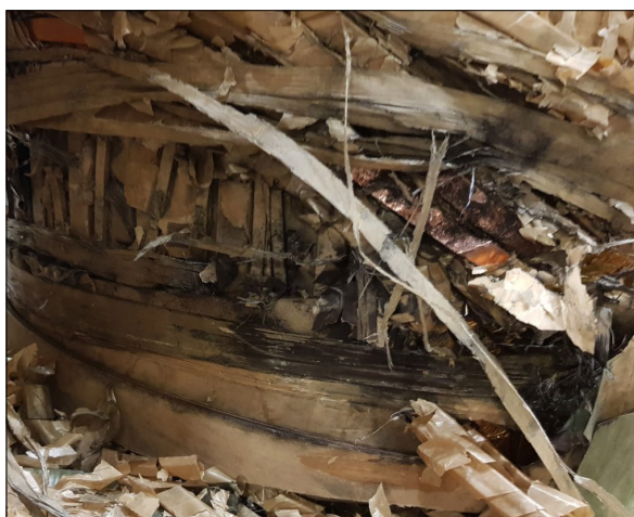
Figura 8: El devanado regulador de la fase C como se encontró durante la inspección visual
